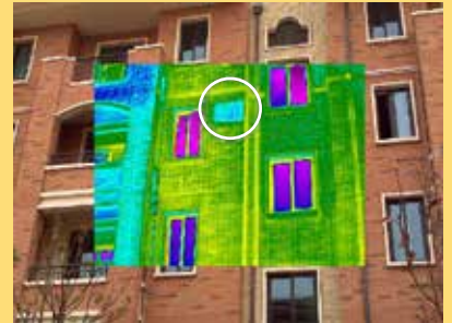
外墙维修后未填实, 该处容易渗水
